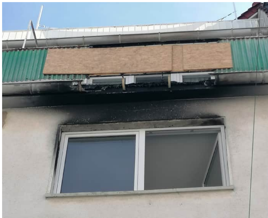
Bauschäden nach Wohnungsbrand im Gebäudekomplex Hohenzollernhof (Quelle: DSK)
