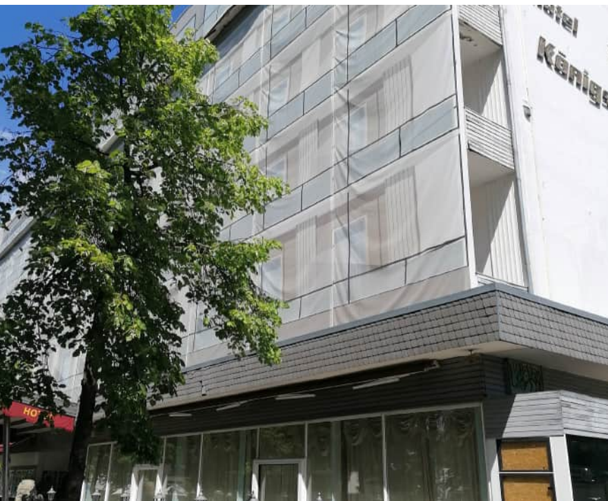
Sanierungsbedürftige Gebäude in der Innenstadt (Quelle: DSK)
